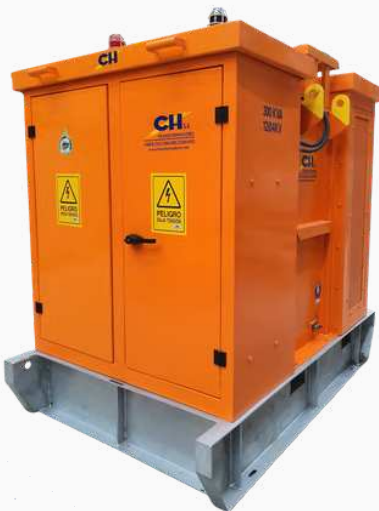
Transformador tipo Pad Mounted, Interior mina
